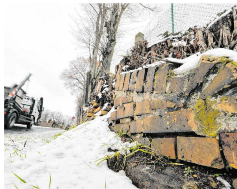
Die Mauer an der Waldhausstraße ist durch die Bäume bereits arg in Mitleidschaft gezogen worden. Archivfoto: J. Rehle
